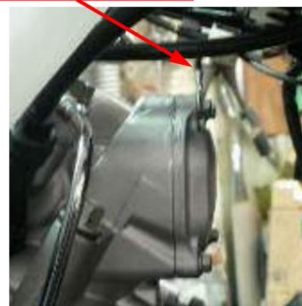
Cavo di terra
